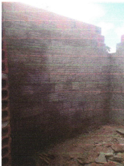
FOTO 14 - CHAPISCO APLICADO EM ALVENARIA (COM PRESENÇA DE VÃOS) E ESTRUTURAS DE CONCRETO DE FACHADA, COM EQUIPAMENTO DE PROJEÇÃO. ARGAMASSA TRAÇO 1:3 COM PREPARO EM BETONEIRA 400 L. AF_06/2014
