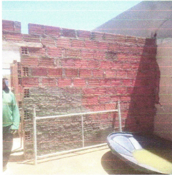
Foto 11 - CHAPISCO APLICADO EM ALVENARIA (COM PRESENÇA DE VÃOS) E ESTRUTURAS DE CONCRETO DE FACHADA, COM EQUIPAMENTO DE PROJEÇÃO. ARGAMASSA TRAÇO 1:3 COM PREPARO EM BETONEIRA 400 L. AF_06/2014
